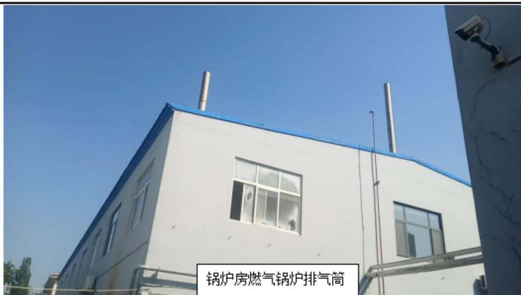
图 4-1 项目废气处理设施
